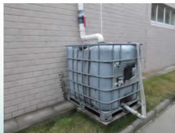
昆山廠雨水收集裝置
