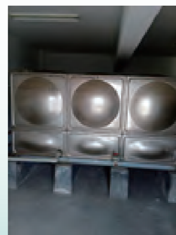
上海廠雨水收集裝置
